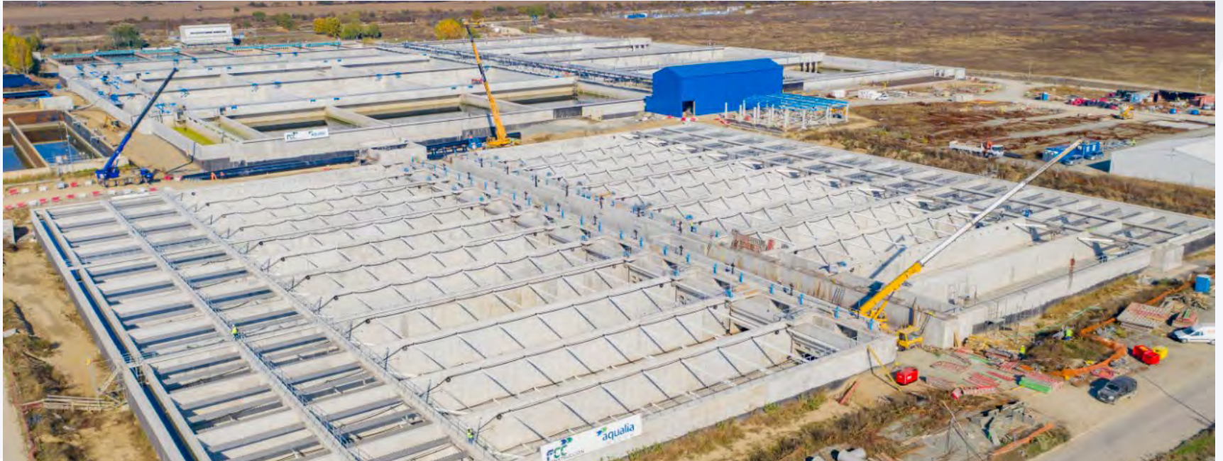
Glina WTP / Rumania
