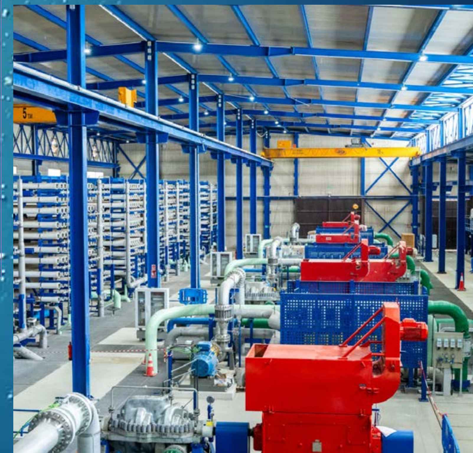
Desaladora Mar de Alborán, en el Parque Natural Cabo de Gata-Níjar (Almería).
