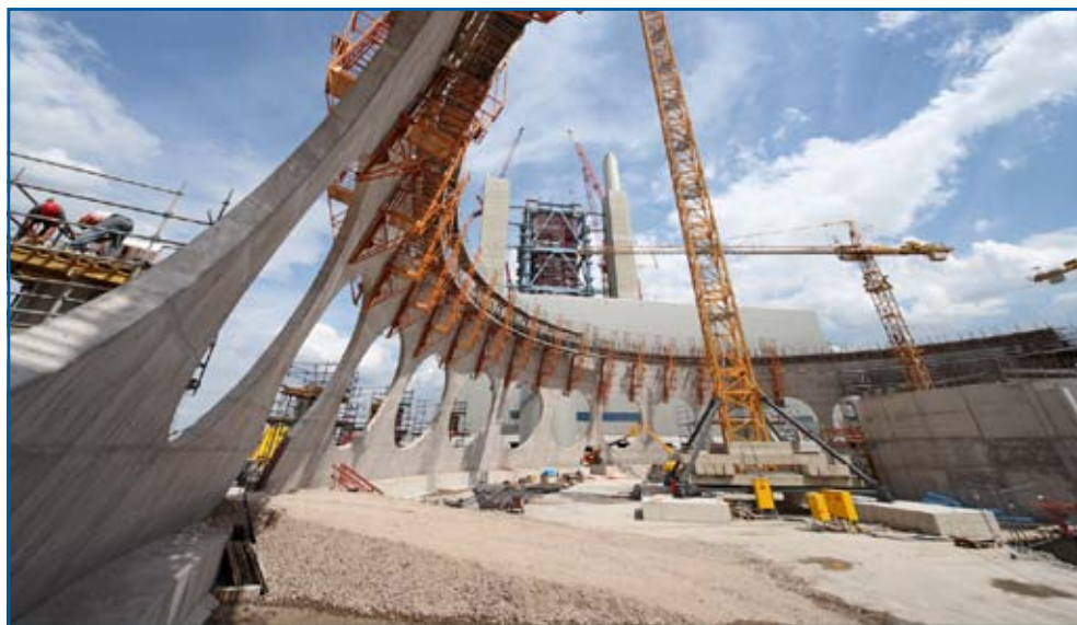
Central térmica de Karlsruhe (Alemania)
