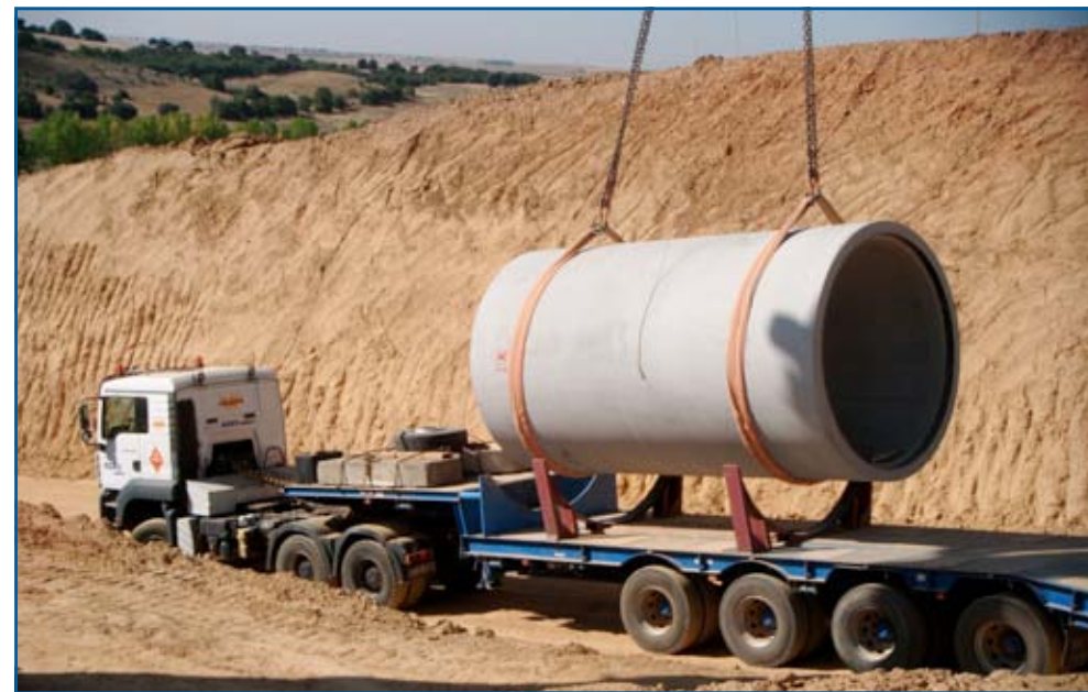
Tubería para conducción hídrica
