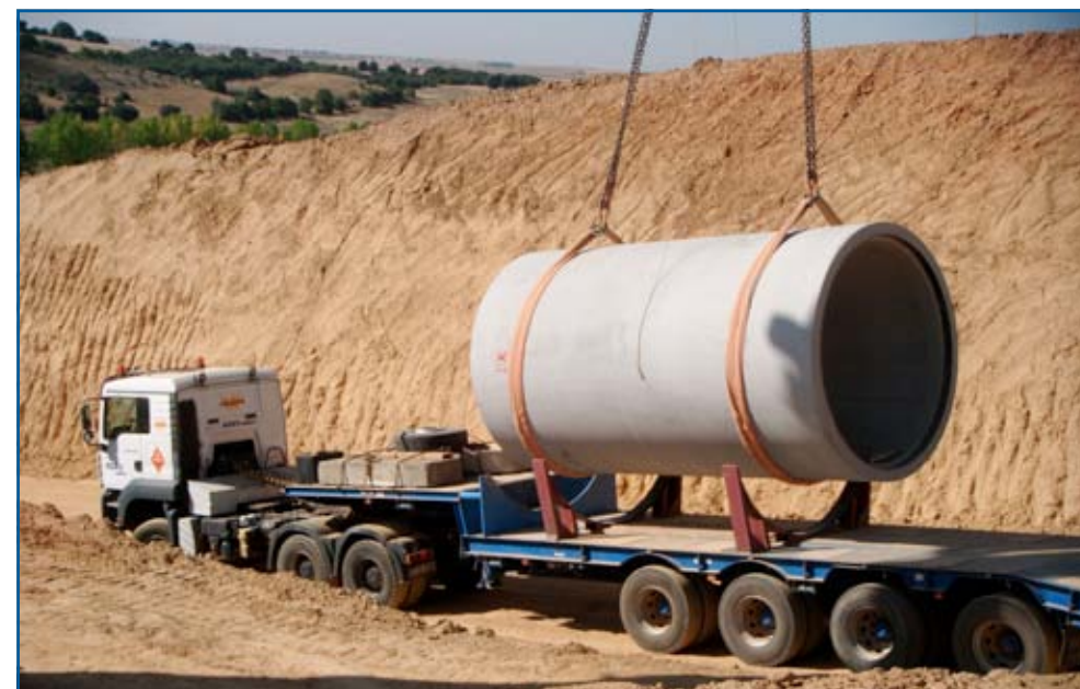
Tubería para conducción hídrica
