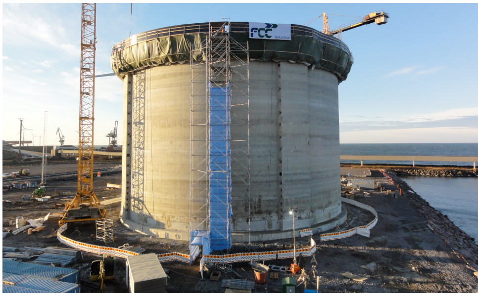
Tanque de GNL en Pori (Finlandia).
