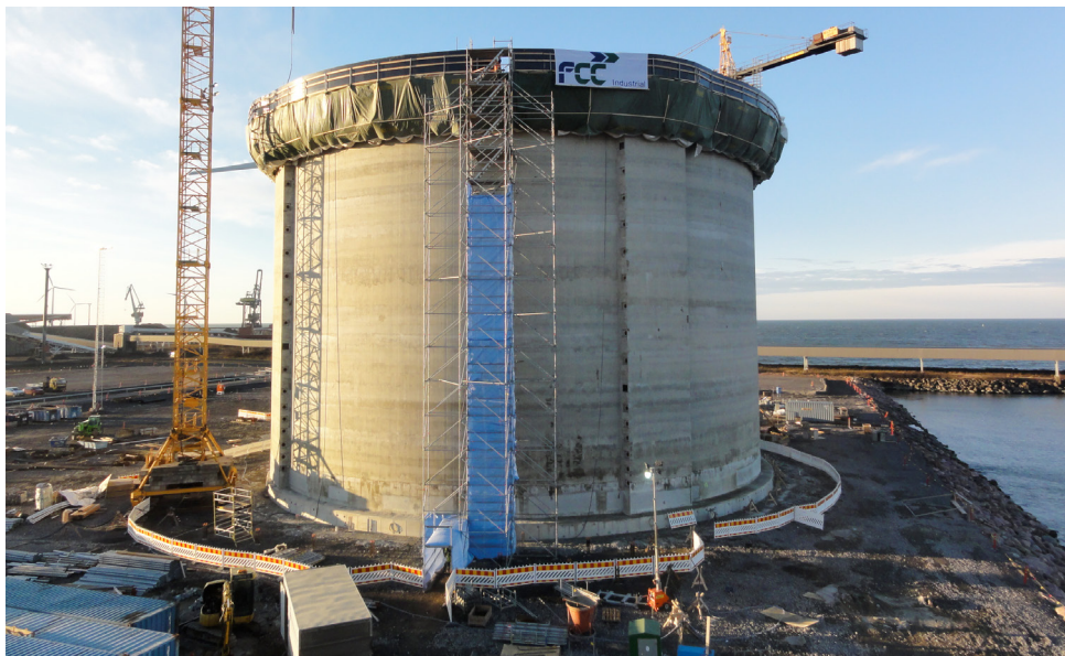
Tanque de GNL en Pori (Finlandia).
