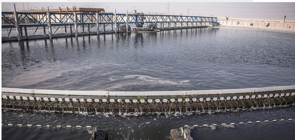
Depuradora New Cairo (Egipto).
