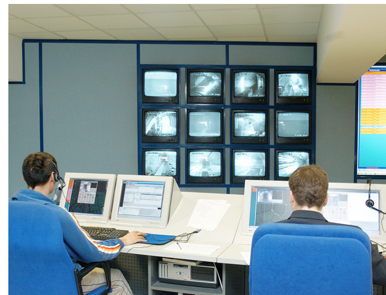
Centro control de galerías de servicio, Madrid.
