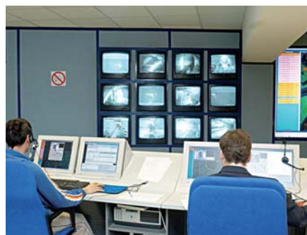
Centro de control de galerías de servicio. Madrid
