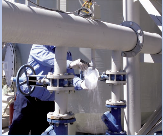
Estación depuradora de aguas residuales. Consentino. Almería
