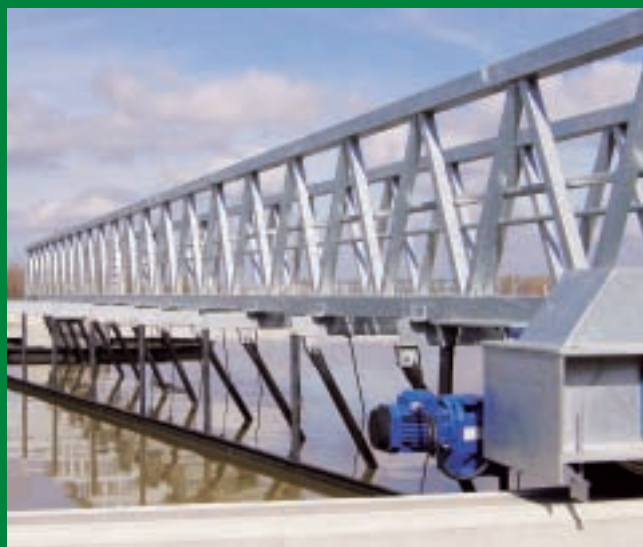
Depuradora de aguas residuales. Salamanca
