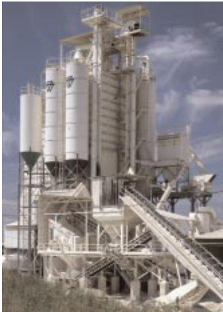
Planta de mortero seco. Álcala de Guadaira. Sevilla
