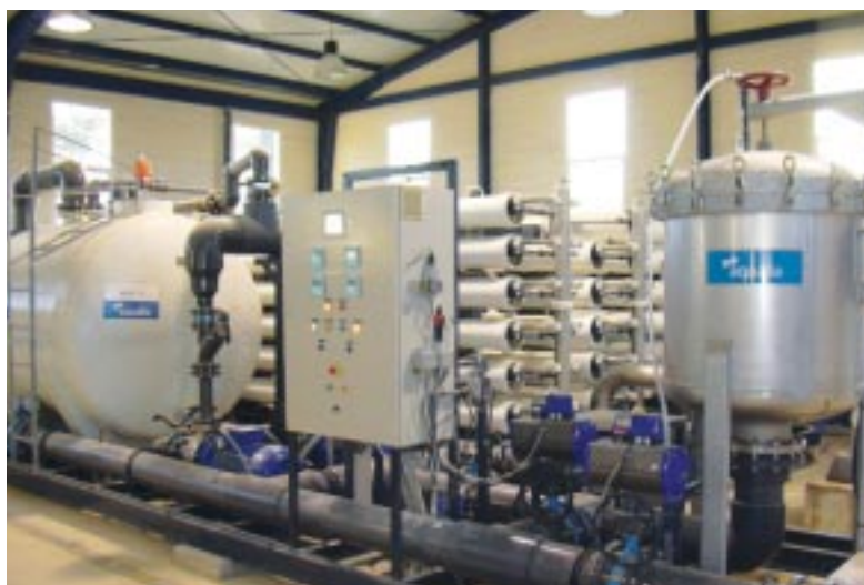
Planta desaladora de Dénia. Alicante
