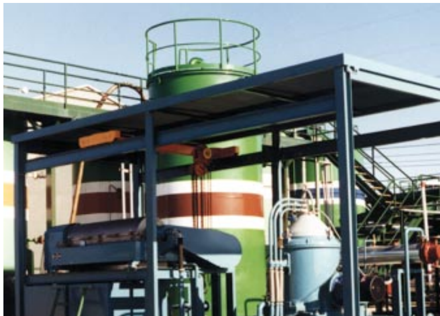
Planta de tratamiento de residuos industriales de Valdebebas. Madrid
