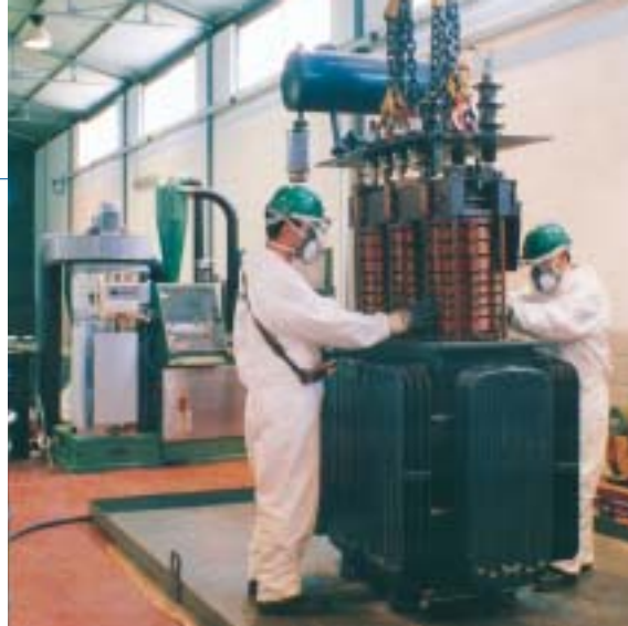
Gestión de transformadores contaminados.
