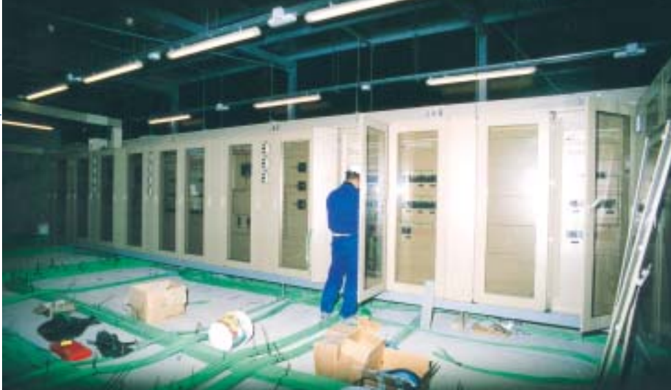
Instalaciones eléctricas del edificio Sogecable. Madrid.
