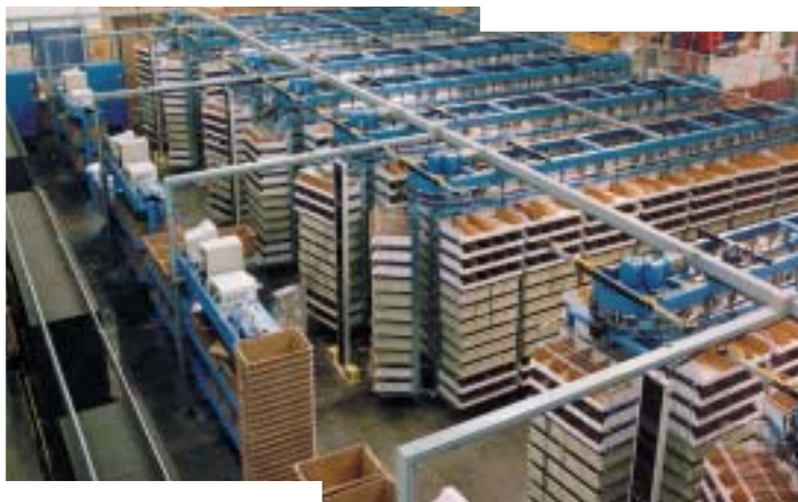
Instalaciones automáticas de picking.
