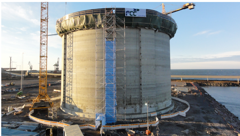
LNG tank in Pori (Finland).
