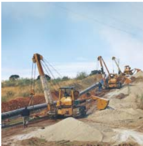
Rivas-Alcala gas pipeline (Madrid).
