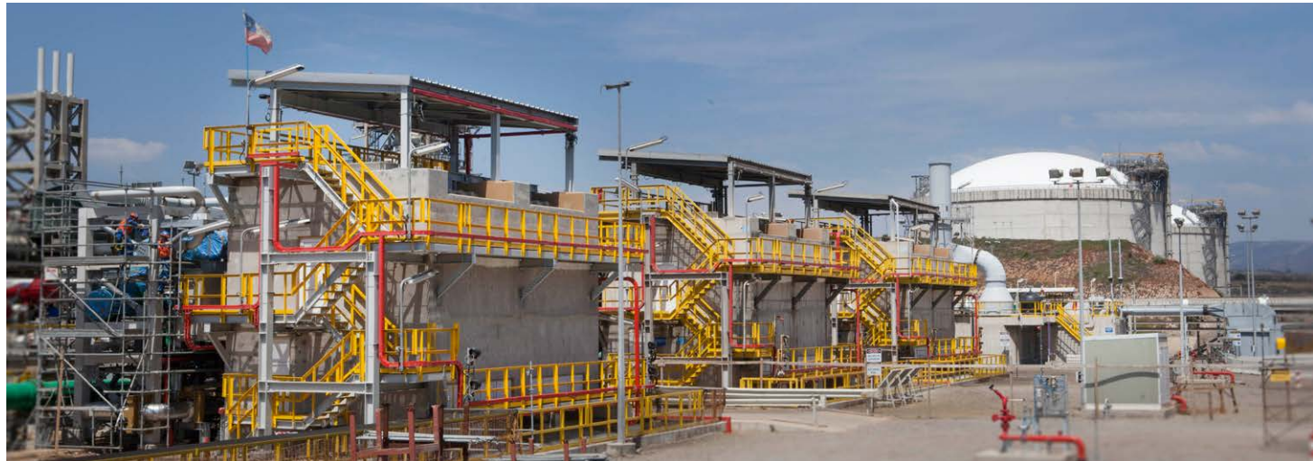
LNG regasification plant. Quintero (Chile).
