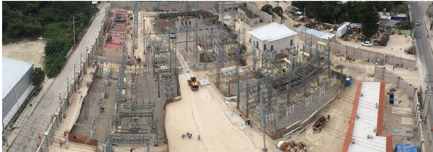
Campeche Electrical Substation (Mexico).
