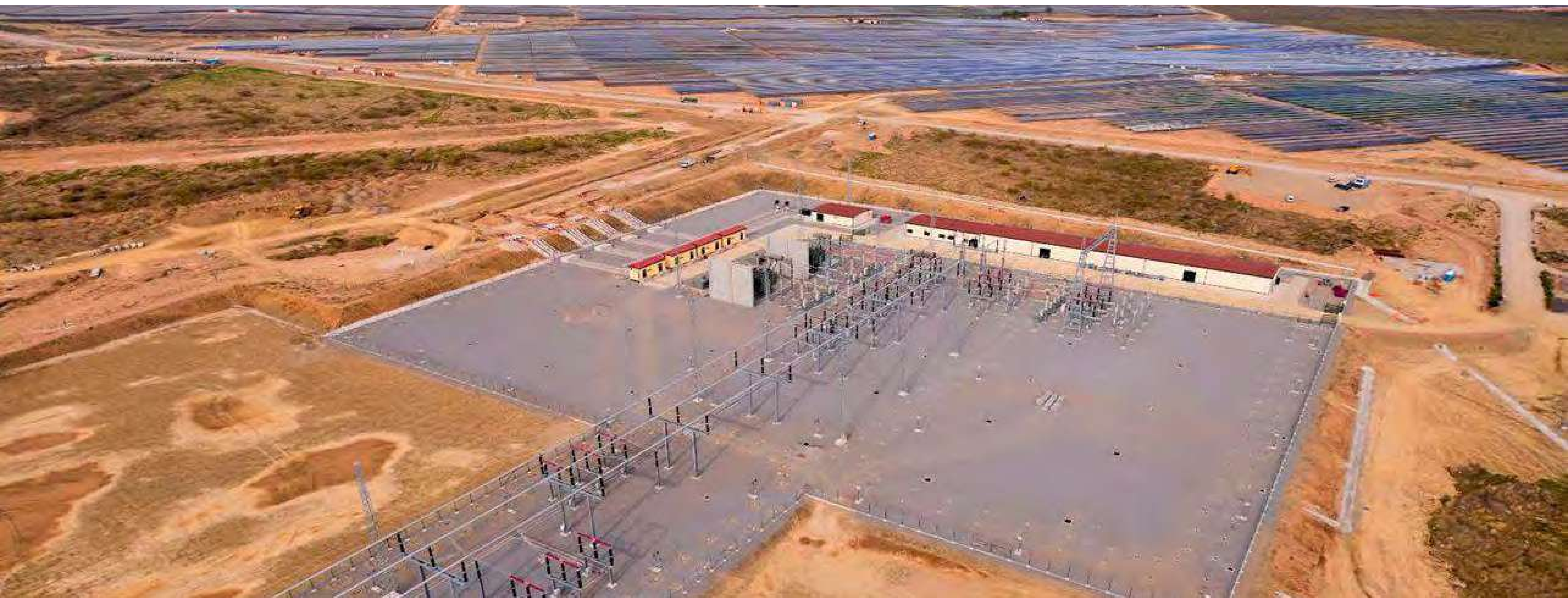
Planta fotovoltaica Pizarro, España
