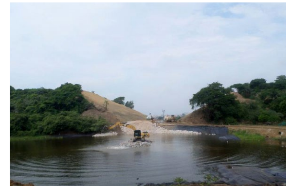
Formación del terraplén mediante fragmentos de roca con diversos tamaños y pesos.
