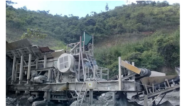
Sistemas de mitigación de polvo mediante tuberías y bombas.
