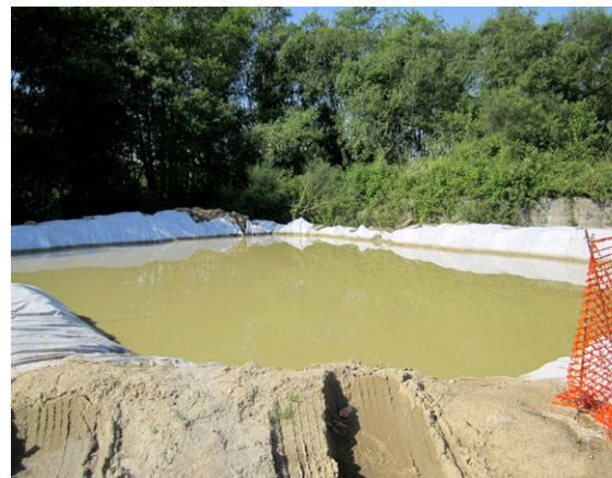
Balsa de decantación de lodos.
