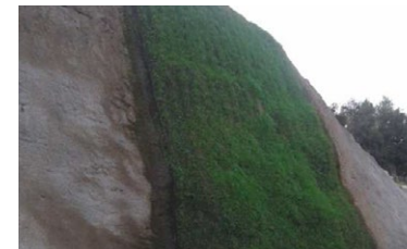
Estado del talud tras el periodo de lluvias otoñales.
