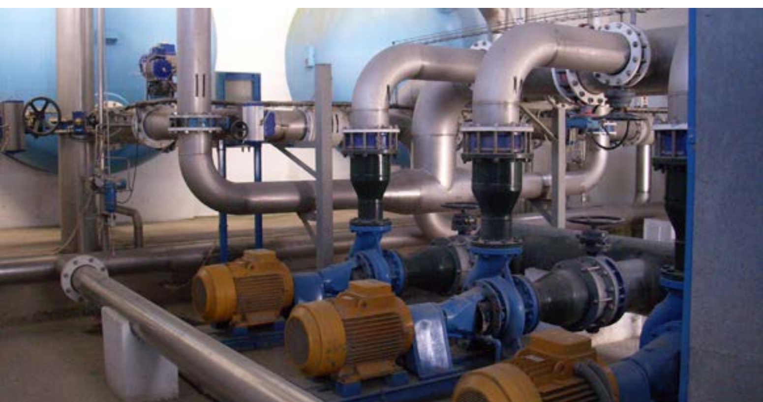
Sala de filtros Estación Depuradora de Agua Potable de Castell de Ferro.
